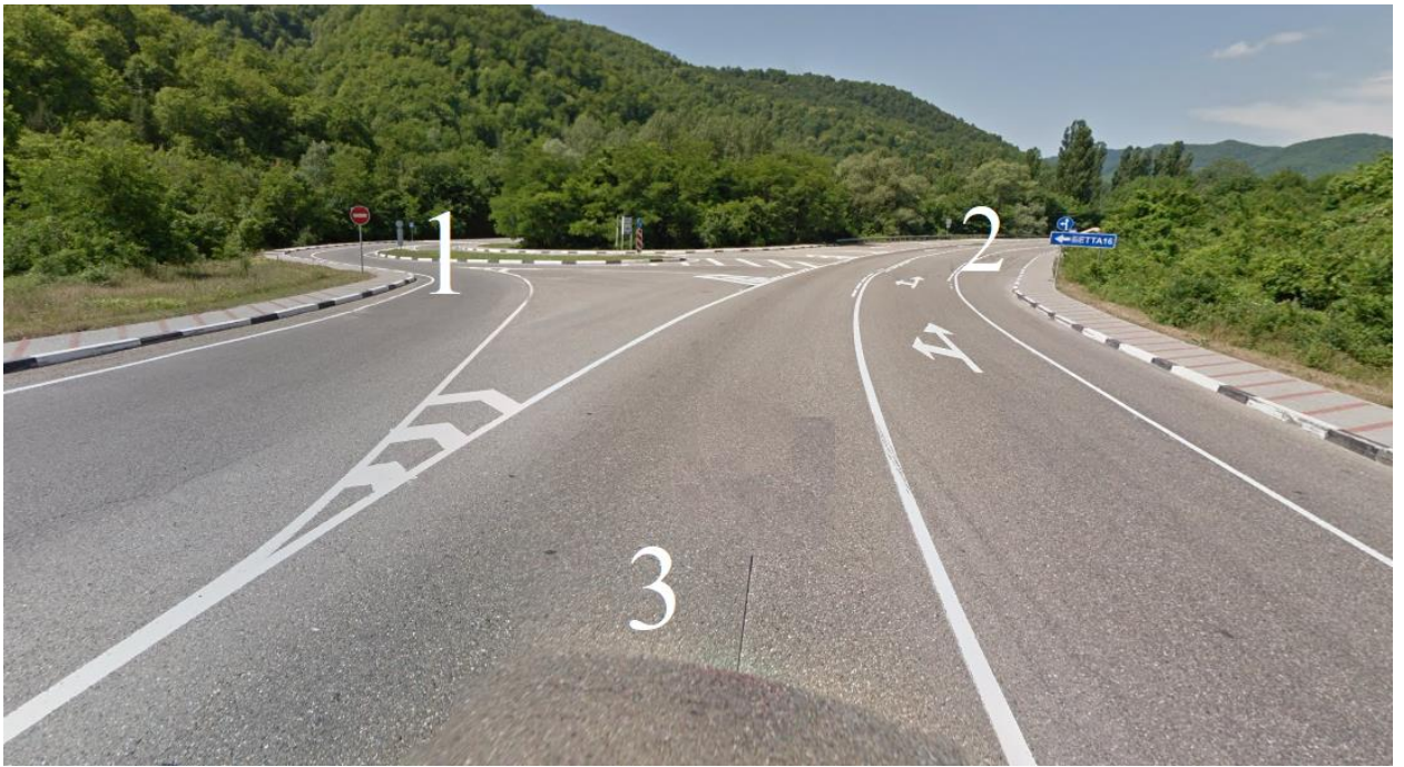
Рисунок А.29.2 – Фото перекрестка М4 поворот на с.Береговое – с. Креница – с. Бетга
