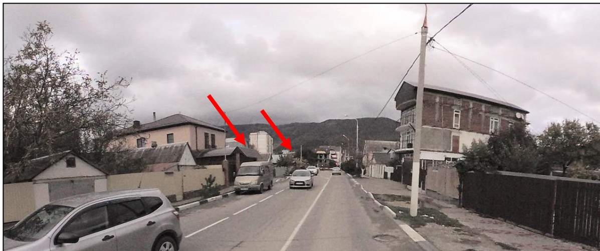
Рисунок 1.9.1 – Участок дороги ул. Новороссийской (от ул. Первомайской до ул. Островского) на момент обследования
