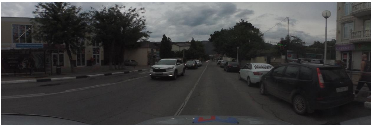
Рисунок 1.4.2 – Состояние дорожного покрытия ул. Кирова на момент обследования
