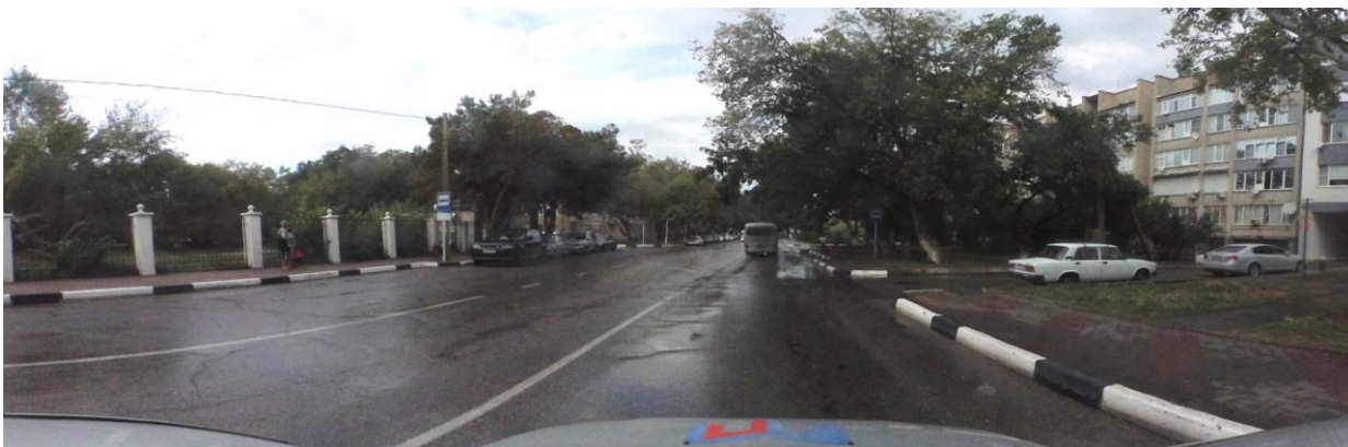
Рисунок 1.4.3 – Состояние дорожного покрытия ул. Островского на момент обследования
