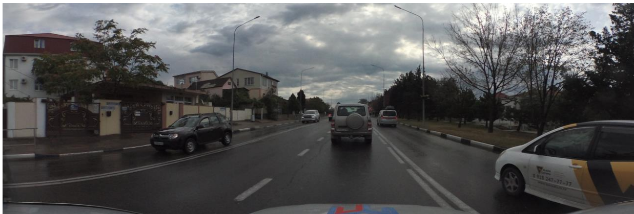
Рисунок 1.4.1 – Состояние дорожного покрытия ул. Луначарского на момент обследования
