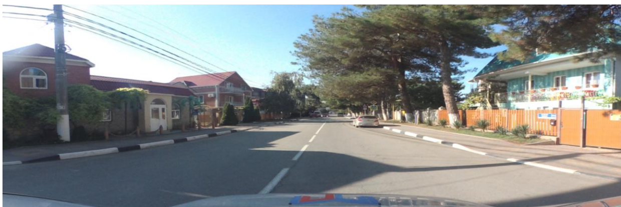
Рисунок 1.4.5 – Состояние дорожного покрытия ул. Ленина на момент обследования
