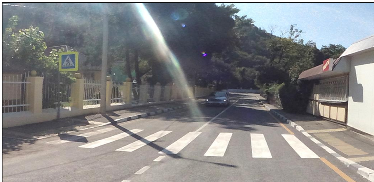
Рисунок 1.7.8 - Пример эксплуатационного состояния горизонтальной разметки 1.1, 1.8 и разметки 1.14.1 (обозначающей пешеходный переход), нанесённых по ул. Черноморской, х. Джанхот
