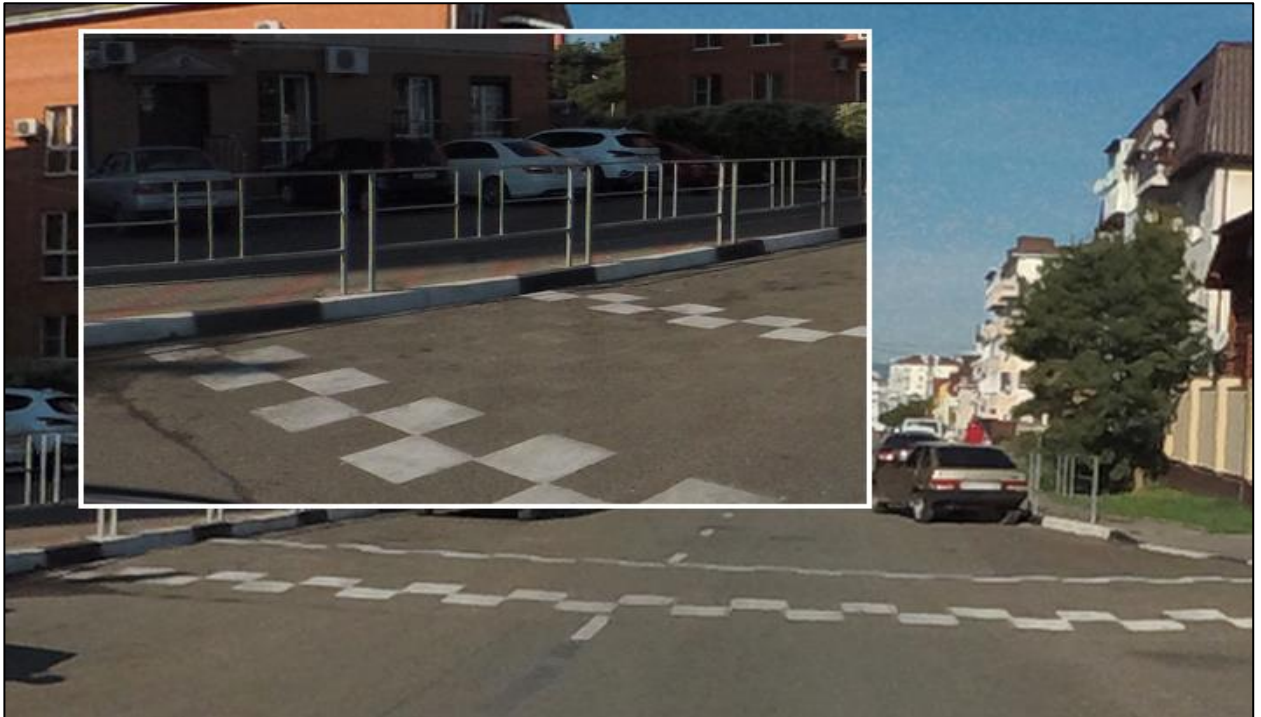
Рисунок 1.7.9 – Пример эксплуатационного состояния ИДН монолитной конструкции, расположенной в г. Геленджик по ул. Дивноморской
