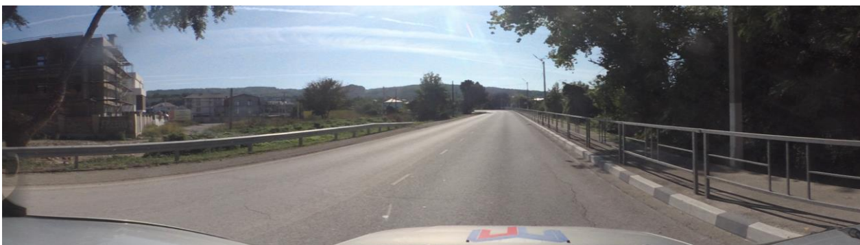
Рисунок 1.4.7 – Состояние дорожного покрытия ул. Короленко на момент обследования
