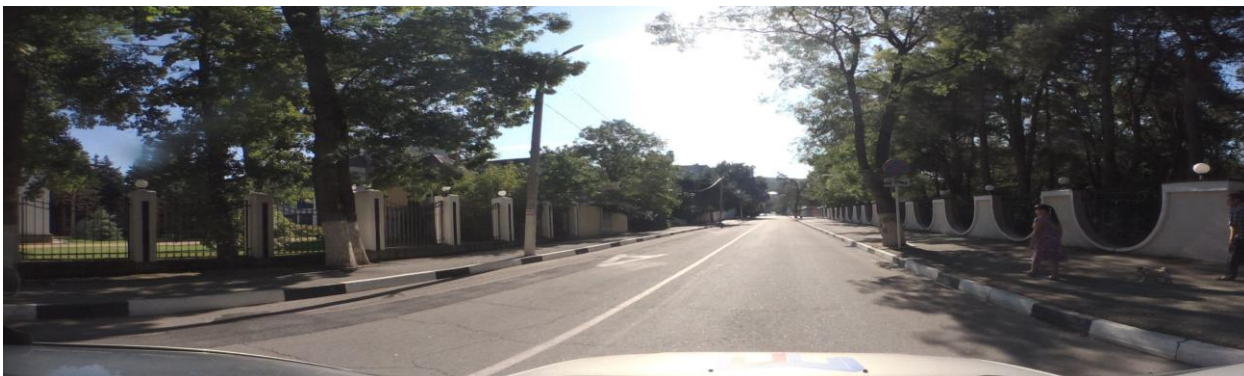
Рисунок 1.4.6 – Состояние дорожного покрытия ул. Кирова на момент обследования
